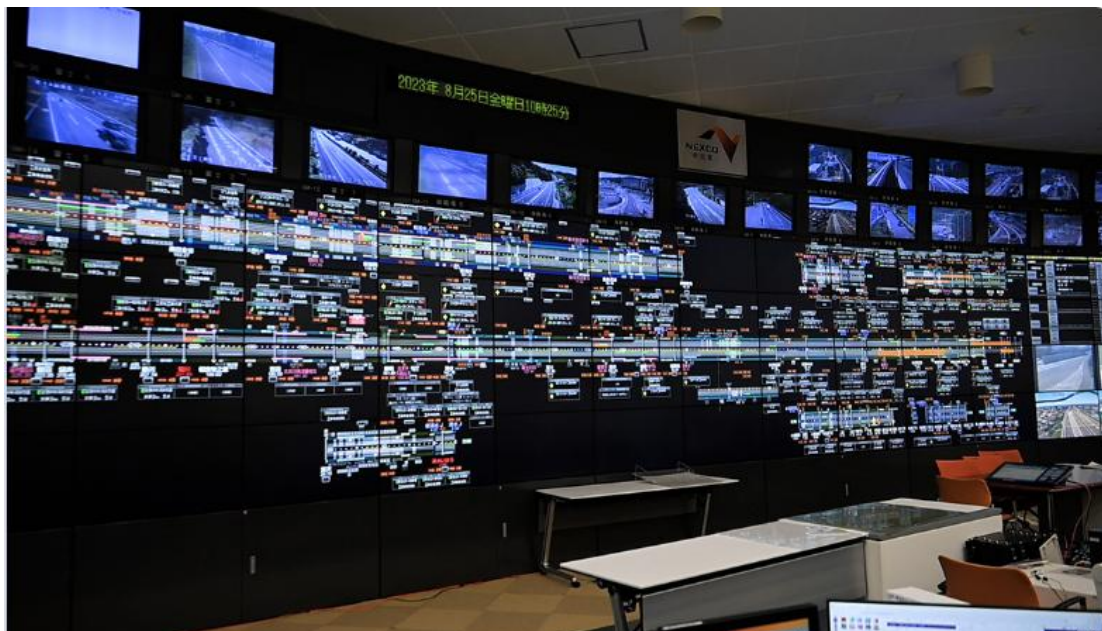
Figura 18: La sala di controllo di NEXCO Central
